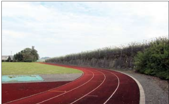
Abb. 8. Ehemaliges Sportgelände. Rechts: Stützmauer und Hecke mit Nachweisen grünrückiger Mauereidechsen-Individuen. Foto: J. GEYER.
